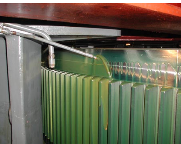
La lubrification en service
